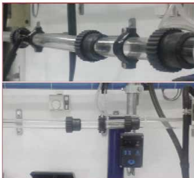
Figura 1. Tubería de leche mal montada al presentar un hundimiento (Foto del autor)
