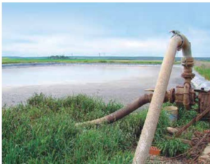
Figura 8. Almacenaje en albercas para riego del líquido separado del purín
